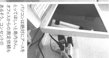
リビングは絶対にアースをとってほしいと島内さん。オアシスからの測定依頼もあるそう。コンセントの下部の細い線がアース
